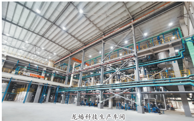
龙蟠科技生产车间
