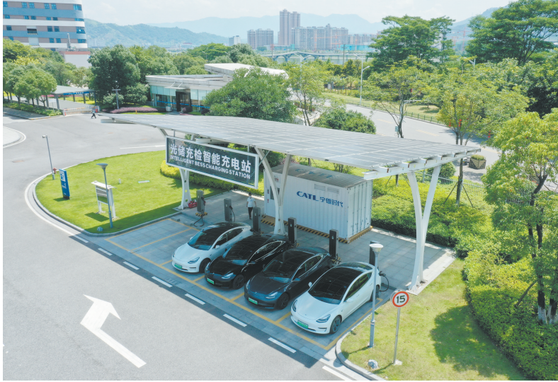
在宁德时代新能源科技股份有限公司科技大楼前拍摄的光储充检智能充电站(2022年6月24日摄,无人机照片)。
