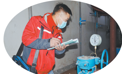
记录换热站各项仪表
